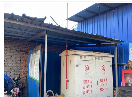
天然气调压柜
